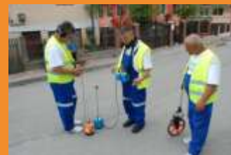
Tehnologii utilizate pentru prelocalizarea pierderilor de apă : teledetectia, georadarul, debitmetrie, loggeri de zgomot.
